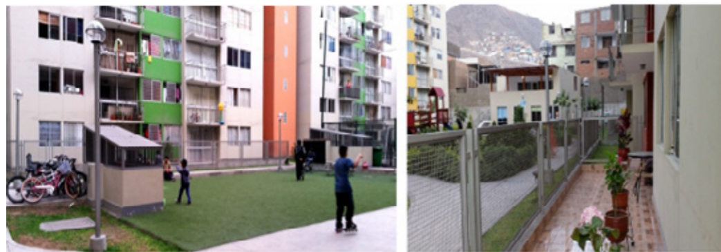
Fig. 9 - Caso B: E4- B terrazas expuestas por falta de vegetación. Fuente: Archivo propio.
