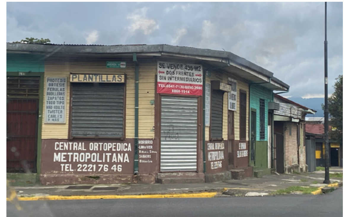
Figura 2- Propiedad deteriorada en venta, Barrio Cristo Rey, San José, año 2023. Fuente. Imagen propia
