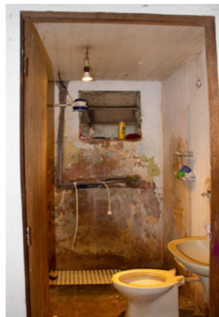
Fig. 3 - Imagem de um banheiro no levantamento de campo do projeto. Fonte: Gabriela Soares, 2023.
