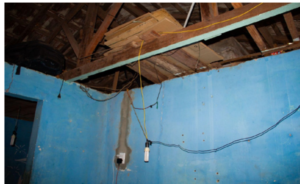
Fig. 2 - Fiação e caixa d'água expostas. Fonte: Gabriela Soares, 2023.
